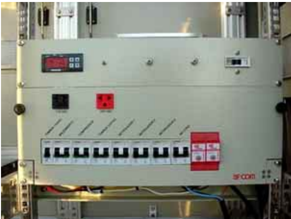
Painel de Distribuição de Energia e Controle da Ventilação forçada
