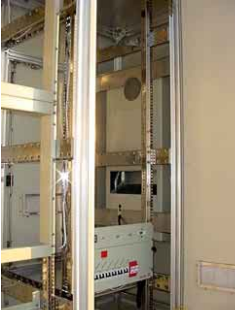
Condicionador de Ar Wall-Mount, interno
