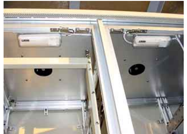
Tomadas de ar da Ventilação Forçada e Iluminação interna
