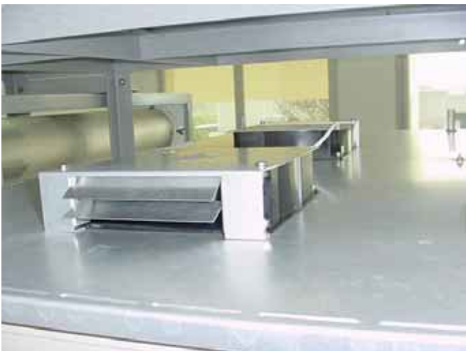
Saídas de ar da Ventilação Forçada com fechamento automático
