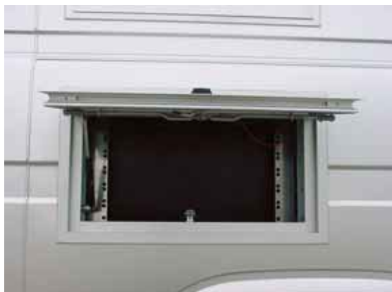
Acesso para painel externo
