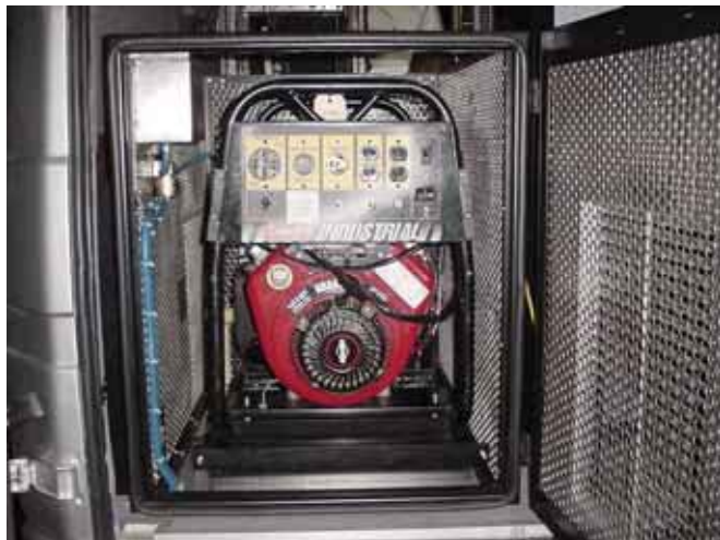
Acesso ao motogerador (montado em suporte deslizante)
