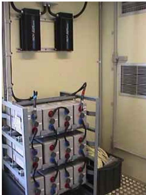
Banco de Baterias e Inversores
