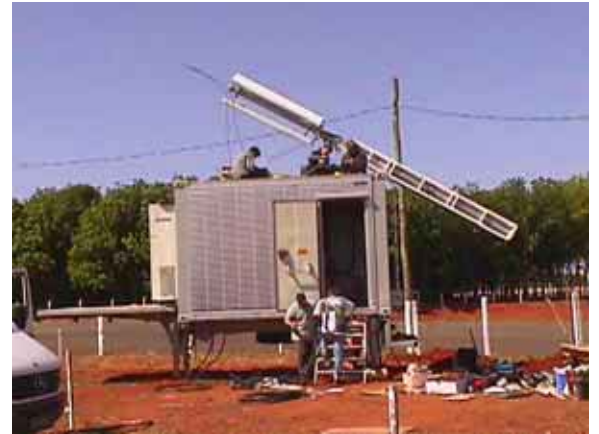
O mastro de 24,3m é transportado horizontalmente sobre o contêiner e facilmente colocado em posição de operação. Em posição intermediária (foto acima), este sistema facilita a montagem das antenas.
