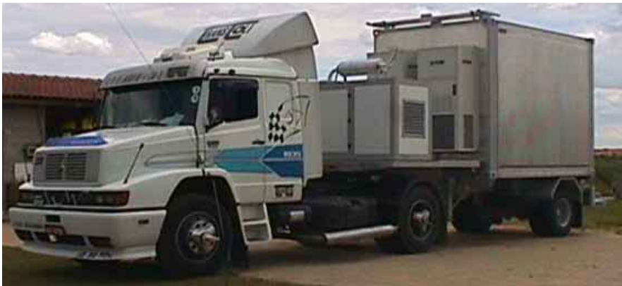
Sistema com grupo gerador externo em abrigo com isolamento acústica.
