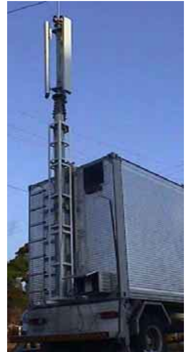
COW 15000 com Caixa e Painel de Controle Pneumático instalados
