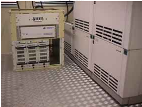
Instalação em ERB Ericsson 884 TDMA, em conjunto com MCPAs
