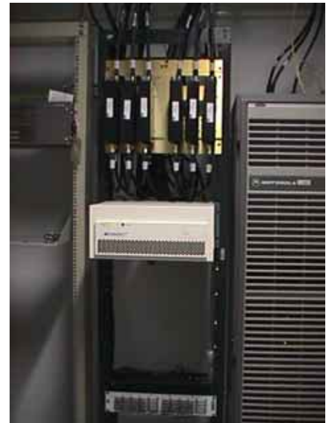
Instalação em BTS Motorola 4812 CDMA, com a retirada dos filtros de Rx
