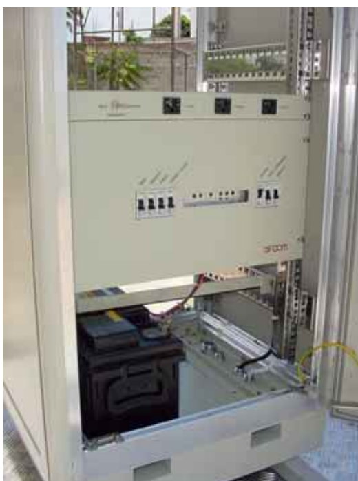
Gabinete com rack 19", bateria, disjuntores e regulador de carga para os módulos solares
